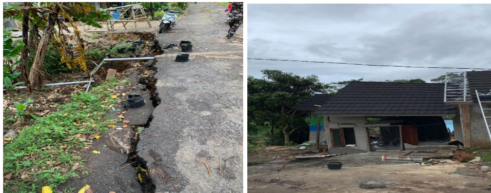
Gambar 3. Bencana Longsor yang terjadi di Kampung Bulakan Desa Talagasari
