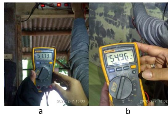
Gambar 6. Pengukuran frekuensi pada (a) PLTPH dan (b) PLTS
