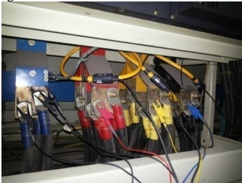
Gambar 3.2 Foto Pengukuran Pada Jaringan 3 Fasa
