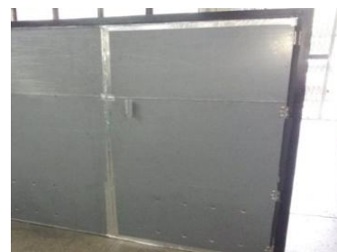
Gambar 10. Kondisi pintu yang tersegel
