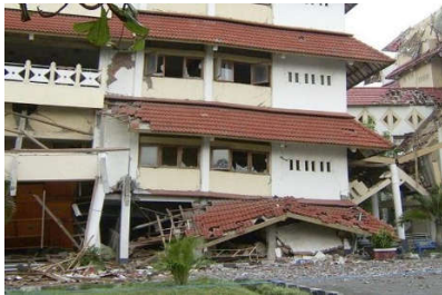
Gambar 1. Kerusakan bangunan pada gedung STIE Kerjasama [2]
