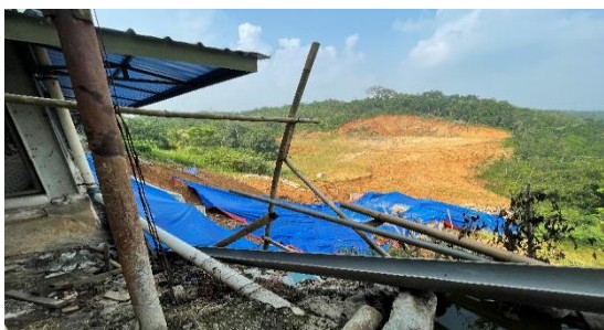
Gambar 3. Area yang Mengalami Longsoran
