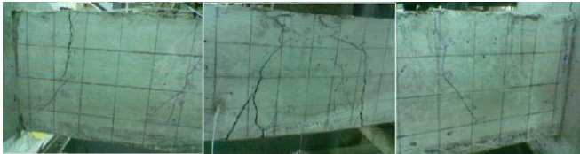
Retak ujung balok kiri Retak lapangan Retak ujung kanan Gambar 10. Retak pada beberapa bagian model balok B-25
