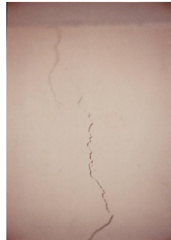
Gambar 1. Retak Tembok akibat defleksi Balok Lantai
