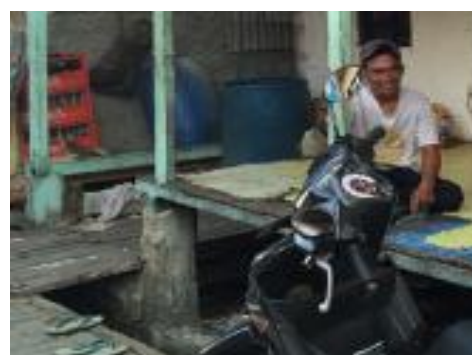
Gambar 10. Kolom struktur bagian bawah rumah dilapisi beton, tangga hilang karena peninggian permukaan jalan
