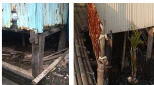
Gambar 9. Kolom struktur bagian bawah rumah berbahan kayu yang ditanam ke dalam tanah.
