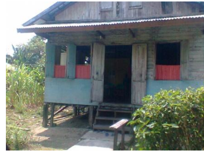
Gambar 2. Dinding rumah rakyat Kalbar yang diganti dari dinding papan (bagian atas) menjadi simpai (bagian bawah).
