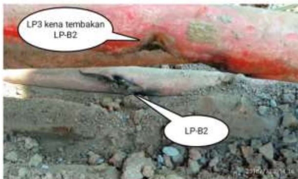
Gambar 10. Kondisi kabel bawah tanah tegangan menengah jaringan feeder LIPPO-3 dan LIPPO-2
