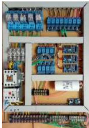
Gambar 3 Perancangan alat pengereman motor induksi 3 fasa.
