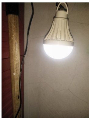
Gambar 22 Pengujian lampu emergency dengan baterai.
