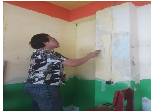
Gambar 9. Pengelupasan cat tembok, untuk dicat Kembali pada ruang kelas
