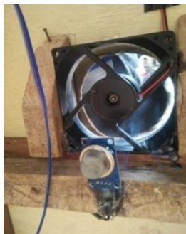
Gambar 6. Sistem menghidupkan exhaust fan untuk mengeluarkan asap dari ruangan
