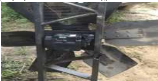
Gambar 3.64. New fan motor
