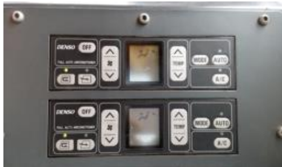
Gambar 12. Pemeriksaan Monitor Panel AC
