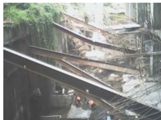
Gambar 9. Perkuatan Sementara D-wall yang Bengkok.
