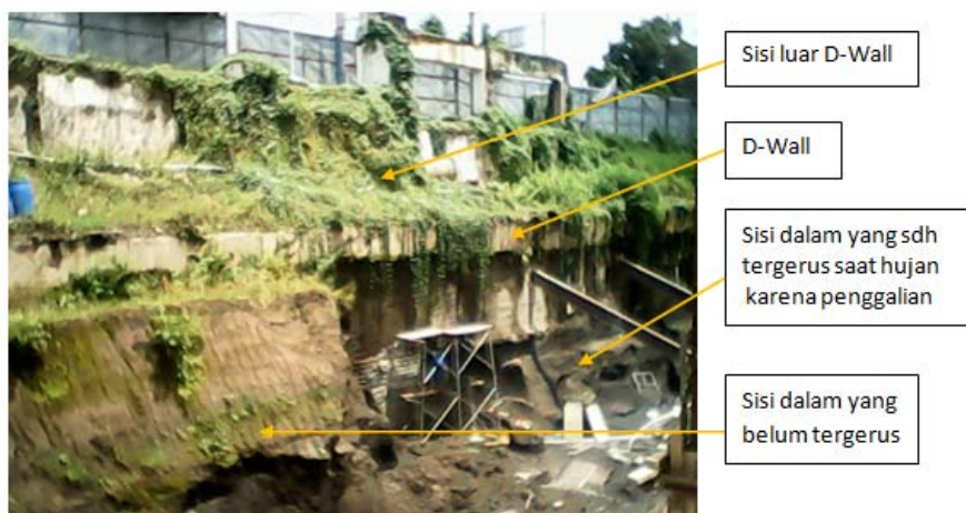
Gambar 2. Kondisi D-wall Sebelum dan Sesudah Tergerus.
