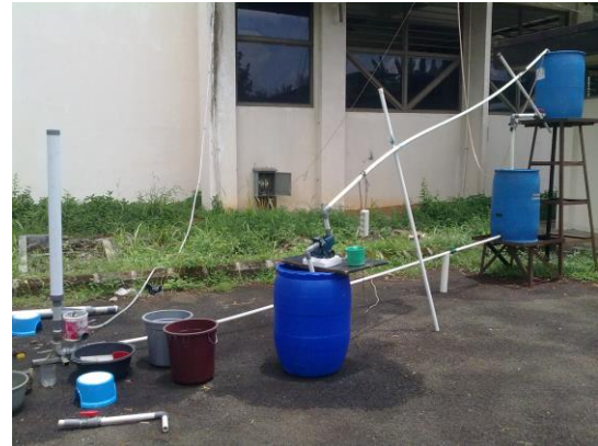
Gambar 6. Hasil pemasangan pompa hydraulic ram pump untuk model alat uji sistem irigasi dan pembangkit listrik.
