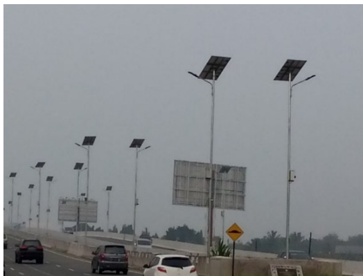
Gambar 3. Solar Cell untuk penerangan jalan menuju Bandara Internasional Kuala Namu, Deli Serdang
